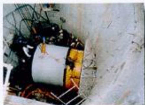
อุโมงค์ระบายน้ำ ซอยสุขุมวิท 38
