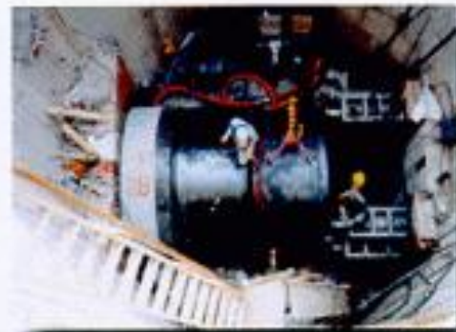
อุโมงค์ระบายน้ำ ซอยสุขุมวิท 42
