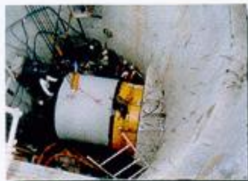
อุโมงค์ระบายน้ำ ซอยสุขุมวิท 36
