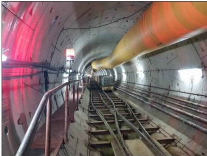
รูปที่ ๒๖ แสดงระบบระบายอากาศภายในอุโมงค์
