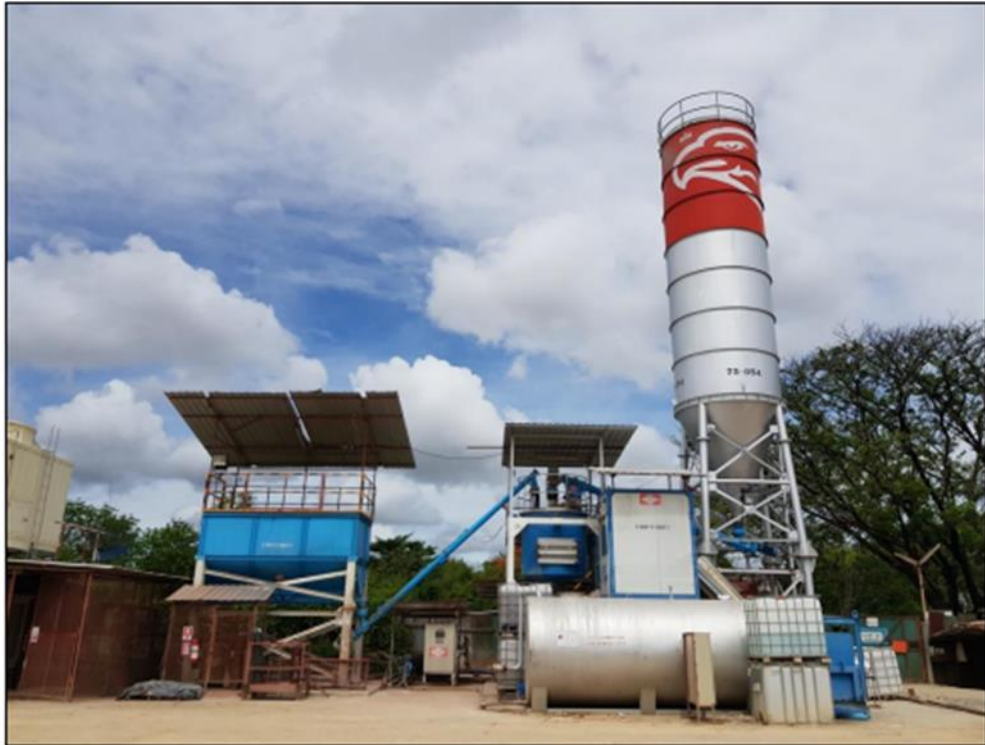
รูปที่ ๒๓ แสดง Grout Plant และ Cooling Tower
