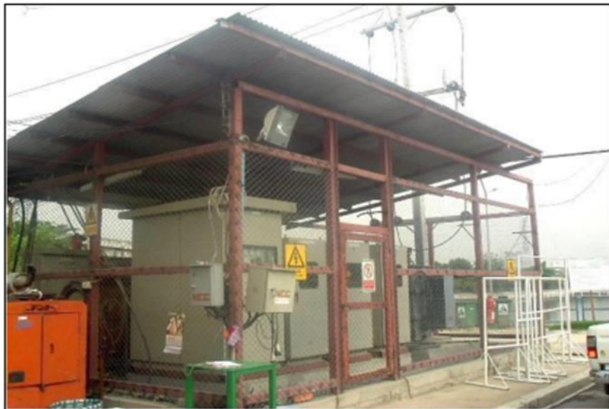
รูปที่ ๒๔ แสดงสถานีไฟฟ้าย่อย Electrical Substation
