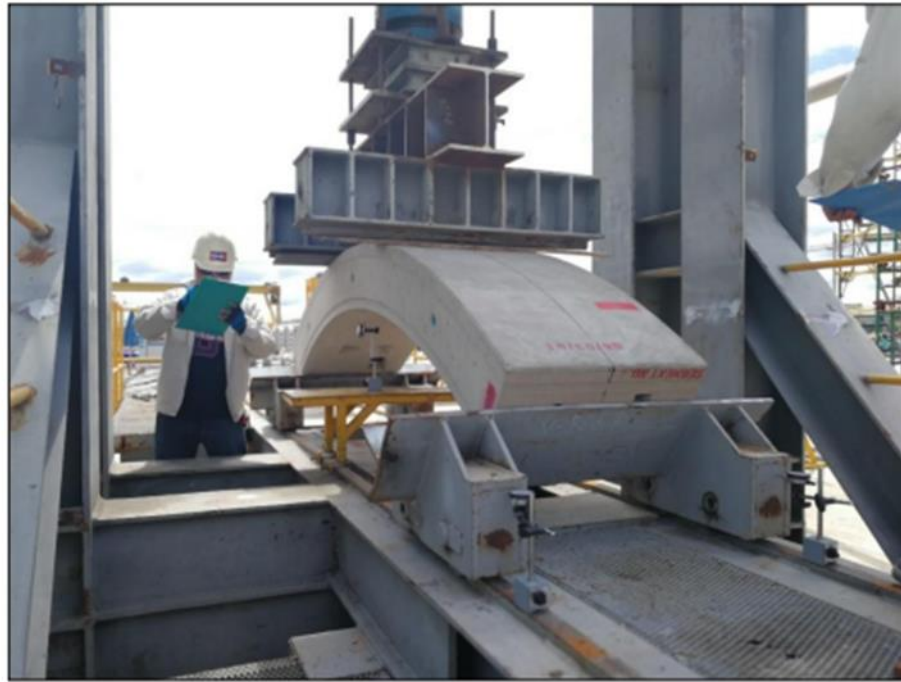
รูปที่ ๙ การเก็บค่าบันทึกผลขนาดของรอย Crack และ บันทึกค่าการเคลื่อนตัวแนวดิ่งและแนวระดับ
